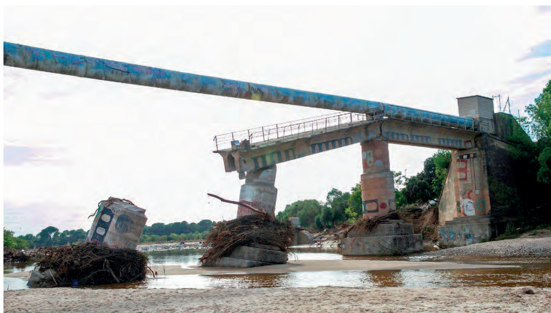
Figura 1: Tubería de Picadas
