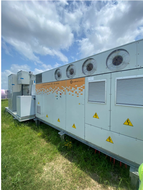
Figura 3.1: Imagen de un inversor solar en uno de los parques de la empresa. Este en concreto se encuentra situado en Myrtle, Estados Unidos.
