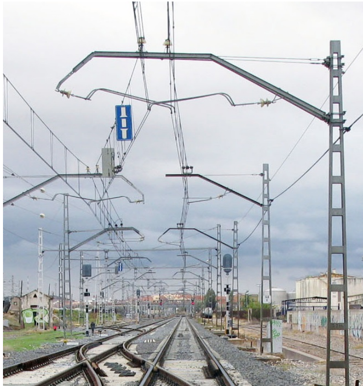
Figura 2.7: Catenaria con ménsulas en celosía.
