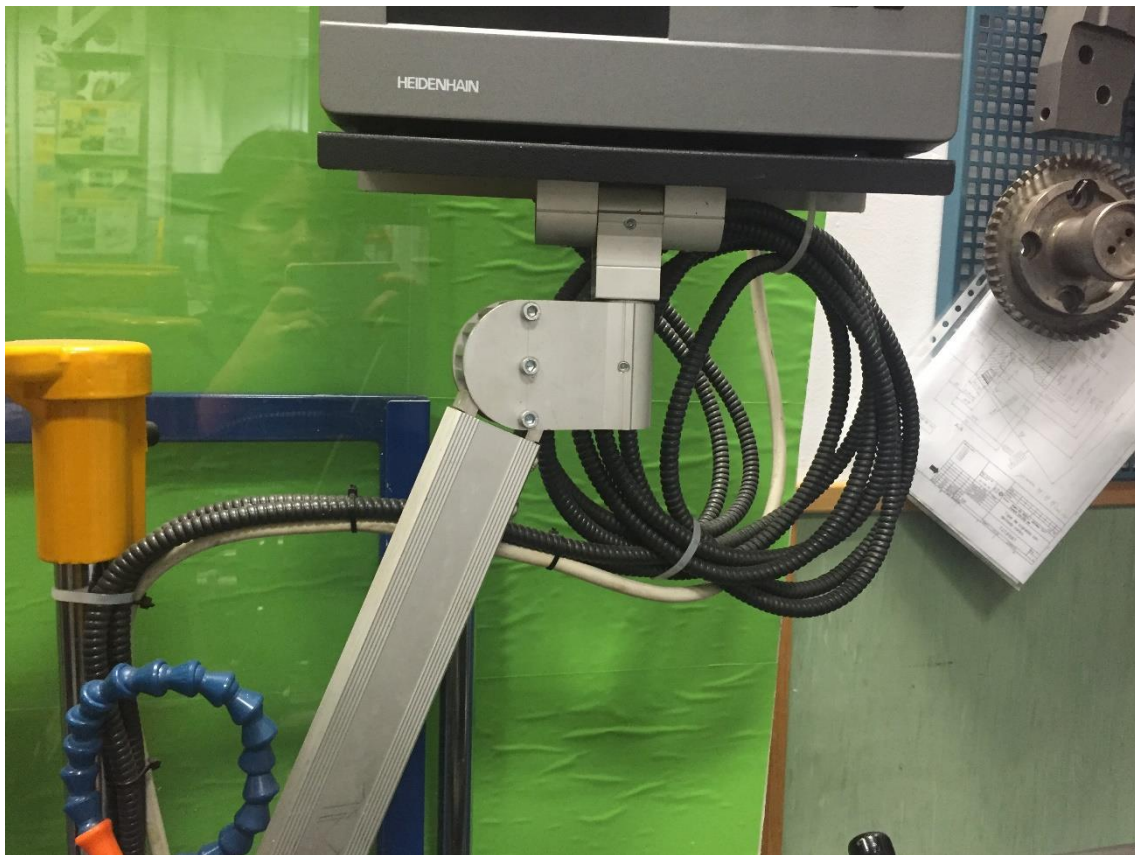
ILUSTRACIÓN 34 - DESPUÉS DE LA 3S, CABLES ORDENADOS.
