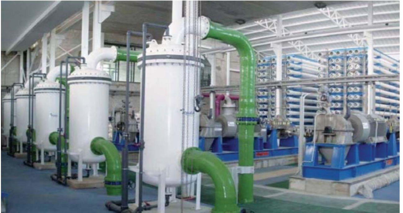
Ilustración 7. Disposición de los filtros verticales, turbobombas y bastidores de la planta. Fuente: Reportaje planta desalinizadora de Santa Eulalia del Río, Aqualia, 2012.
