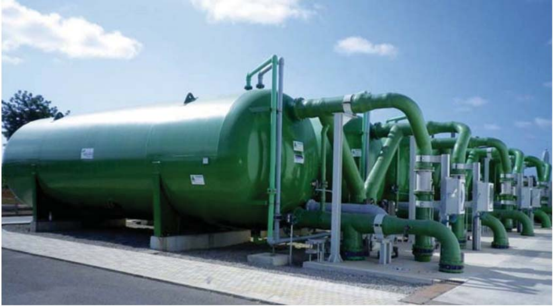
Ilustración 5. Filtros tricapa IDAM Santa Eulalia. Fuente: Reportaje planta desalinizadora de Santa Eulalia del Río, Aqualia, 2012.
