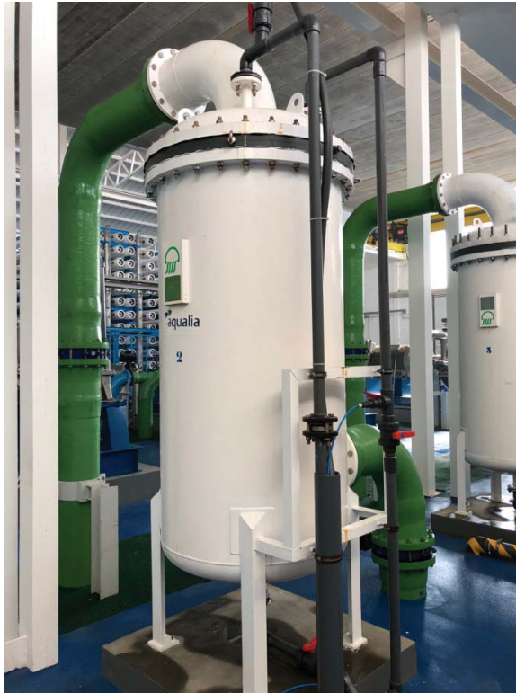
Ilustración 6. Filtros de cartucho IDAM Santa Eulalia. Fuente propia.
