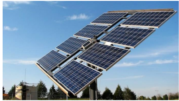
Img.14. Módulos fotovoltaicos.
