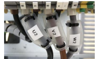
Img.60. Manguera de potencia.
