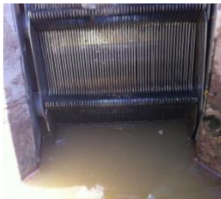
Figura 20 Rejas de desbaste. Fuente: [CLED20]
