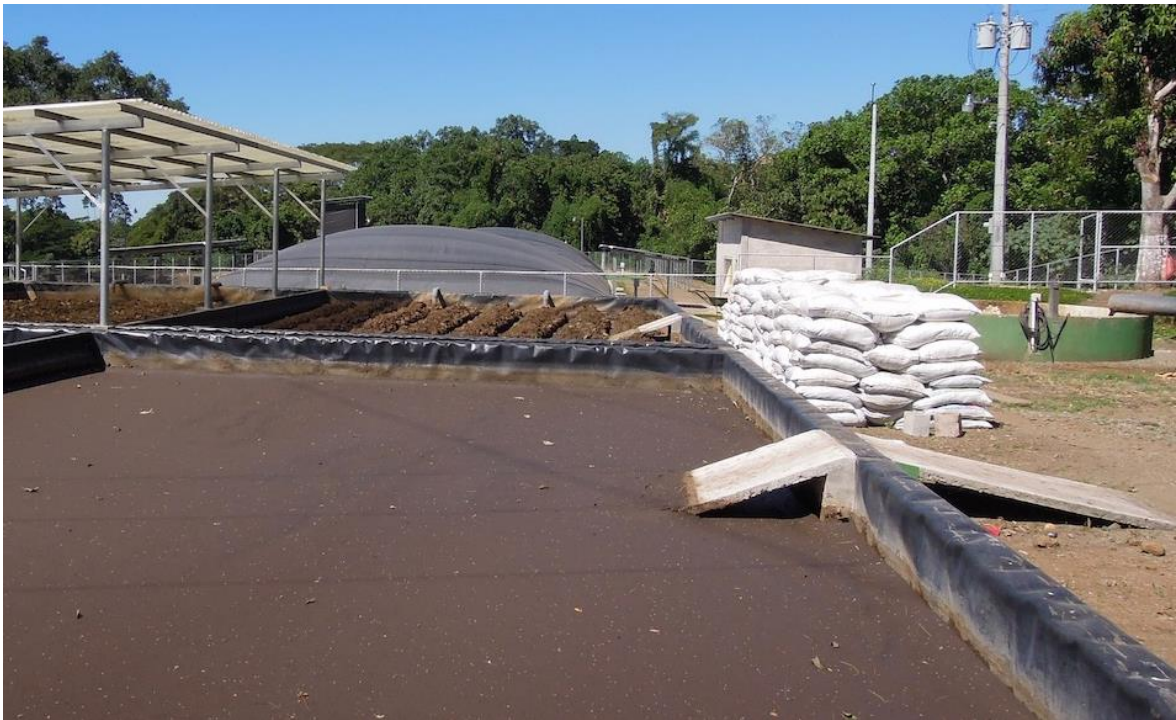
Figura 30: Lecho de secado de lodos de biodigestor de carga continua. Fuente: Manual del biogás
