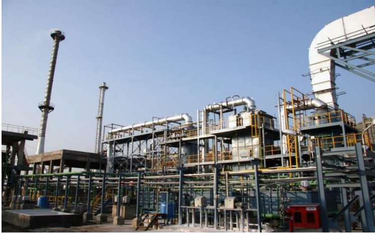
Figura 5. Planta de tratamiento de residuos peligrosos, India.[7]
