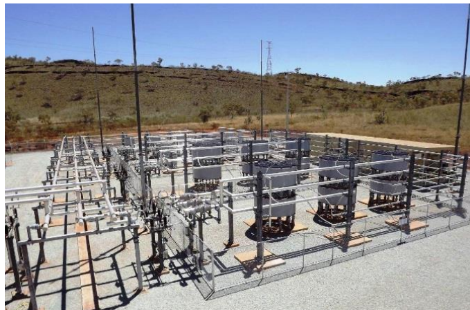
IMAGEN 2 | SVC CAPACITIVO EN JUNA DOWNS, AUSTRALIA
